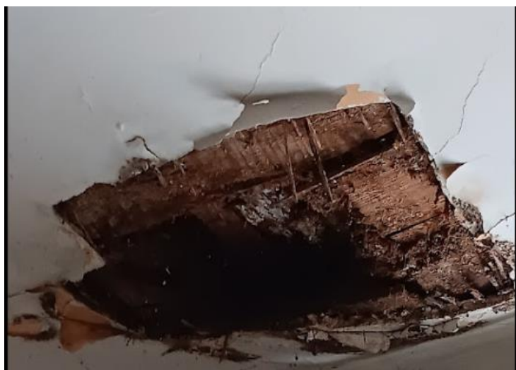
Zniszczenia stropu nad parterem
